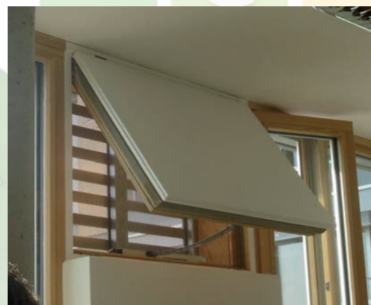
Nachtluftklappe Quelle: Hochbauamt
